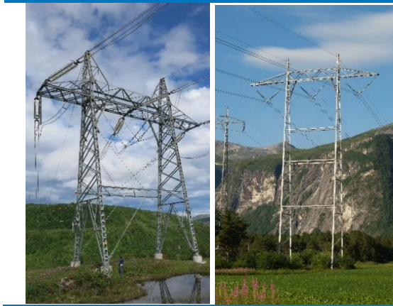
Figur 2-2. Eksempler på forankringsmast (venstre) og bæremast (høyre)
